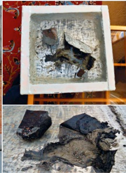
Дом, на который пикировал метеорит Фаменин (Famenin, Иран); фрагмент крыши с пробоиной от приземления космического гостя
